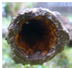
【錆の溜まった水道管】
